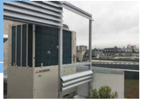
Hotel Moxxy Bastille (Paris 11) - Production d'ECS de 24 chambres
